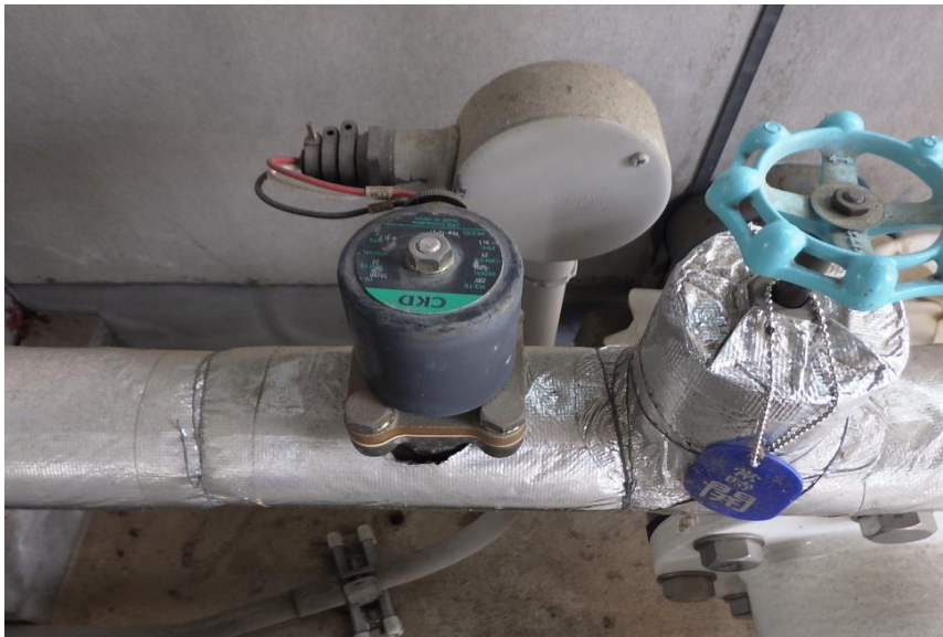
遠山ポンプ場 送水ポンプ真空設備 吸気弁 近影 送水ポンプNo.1用
