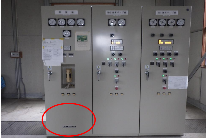
遠山ポンプ場 計装盤内 UPSバッテリー交換用
