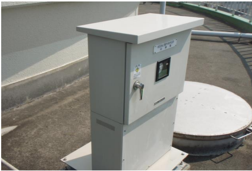
君ヶ岡配水池 低区No.2水位計
