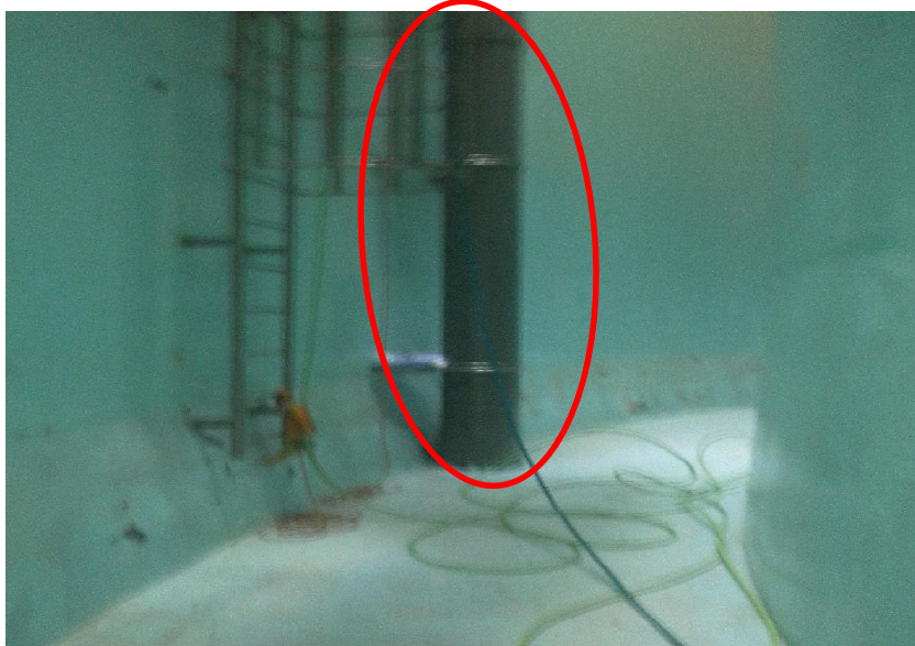
君ヶ岡配水池 低区No.2水位計 防波管内部(水位発信器 投込式)
