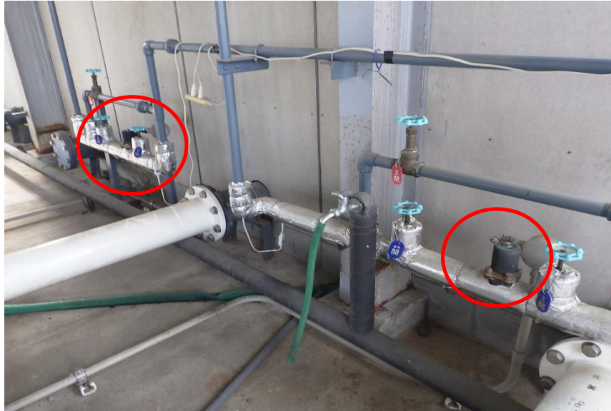
遠山ポンプ場 送水ポンプ真空設備 吸気弁 2台
