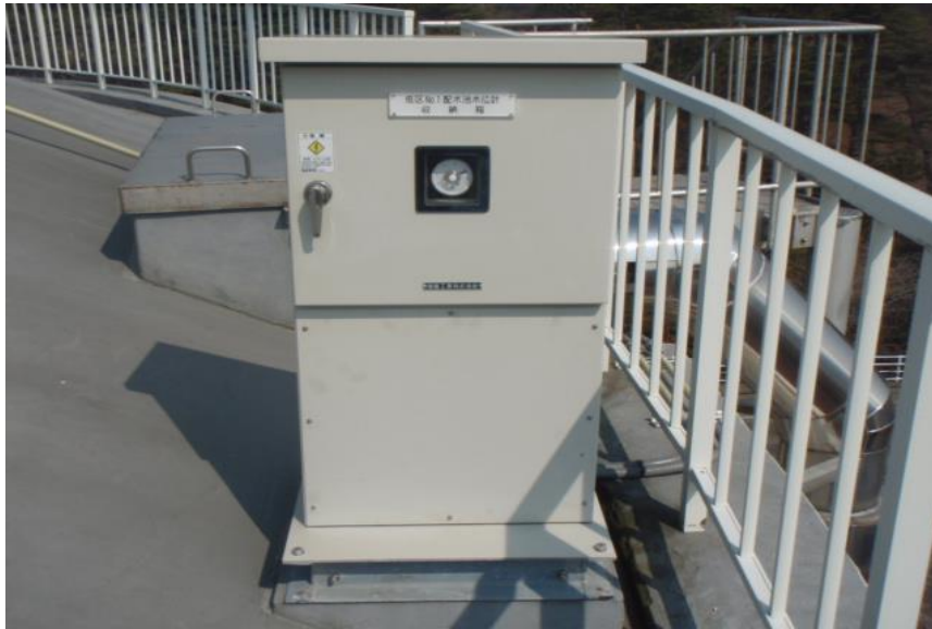
君ヶ岡配水池 低区No.1水位計
