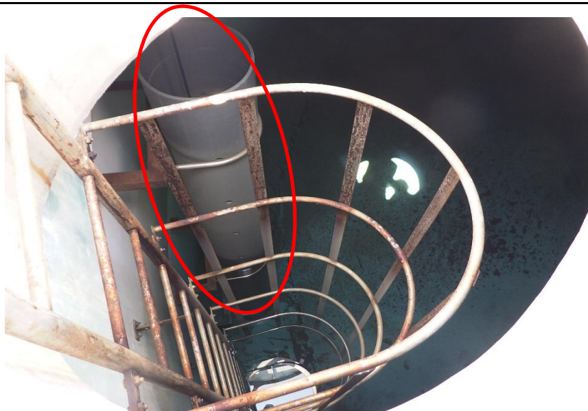
君ヶ岡配水池 高区水位計 防波管内部(水位発信器 投込式)
