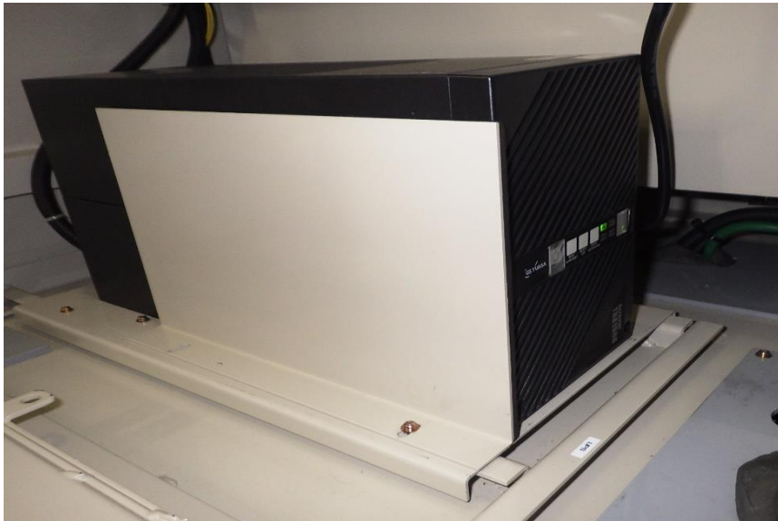
遠山ポンプ場 計装盤内 UPSバッテリー交換用 近影
