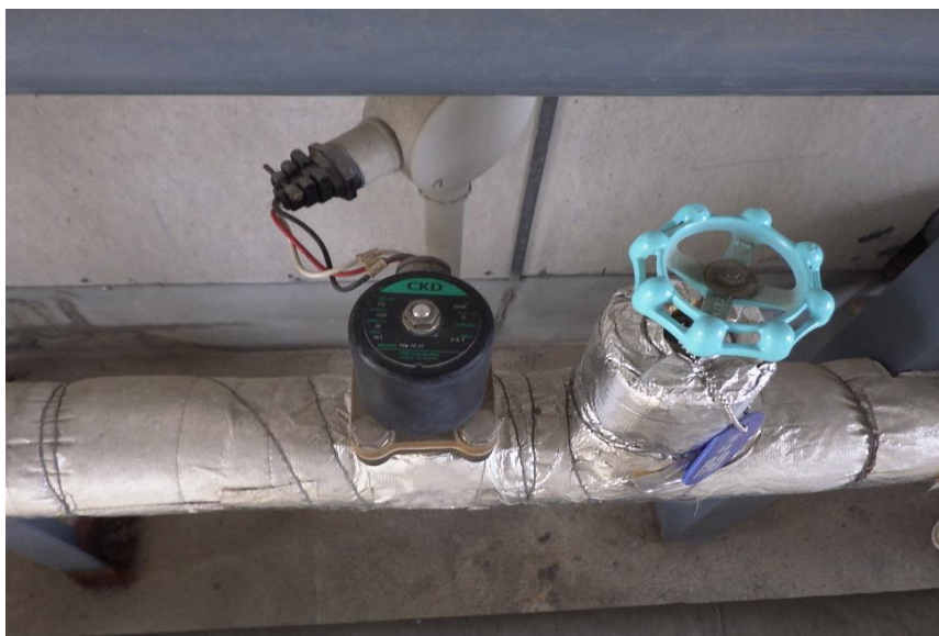
遠山ポンプ場 送水ポンプ真空設備 吸気弁 近影 No.2送水ポンプ用
