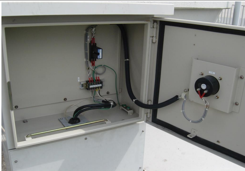
君ヶ岡配水池 低区No.2水位計 ※収納箱は利用
