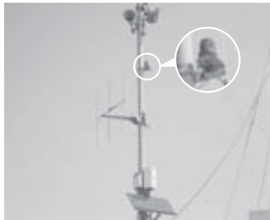
▲デジタル化された防災無線。太陽光発電装置が採用され、停電時でも危険を促すことが可能となった
