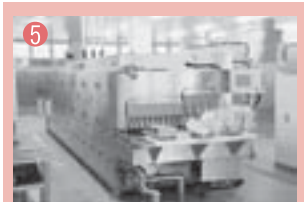
5 学校から戻った食器や食缶を洗浄する場所です。3種類の洗浄機を設置し、食器等を洗浄します。
