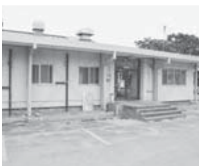
被災した旧学校給食センター
