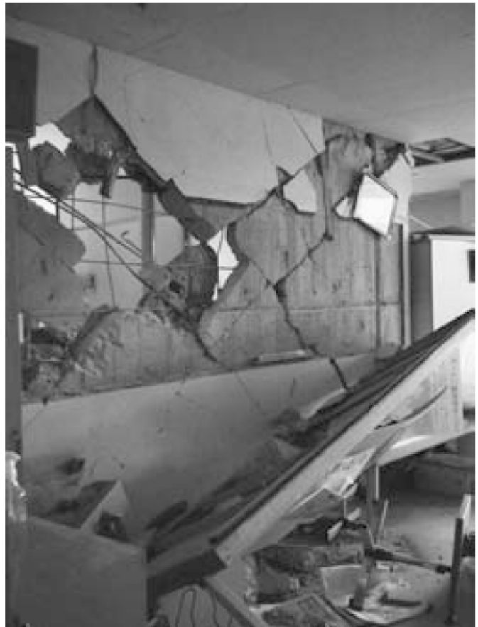
▲東日本大震災で被害を受け、壁が崩れ落ち、鉄筋がむき出しとなった旧校舎内
