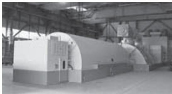
◀4号機の心臓部。左から発電機、低圧蒸気タービン、高中圧蒸気タービン、ガスタービン。
