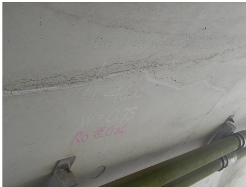
覆工（アーチ）のひびわれ「Ⅰ」
