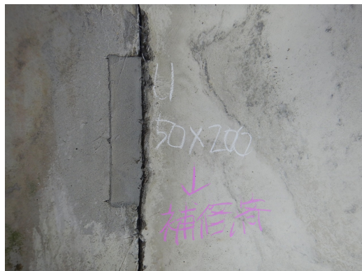
覆工（アーチ）のうき
