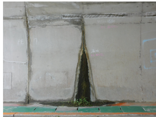
側壁の漏水・水平打継目モルタルのうき「Ⅱb」
