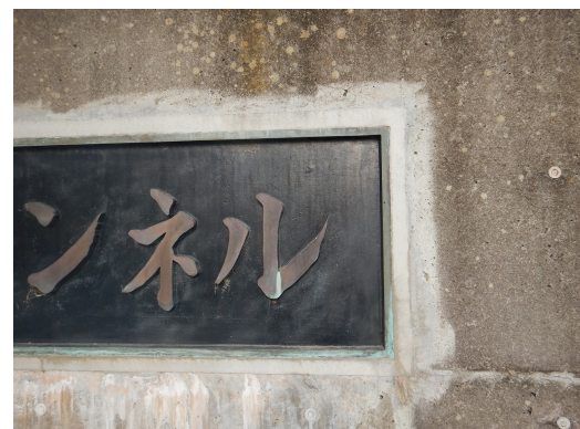
銘板水切りモルタルのうき
