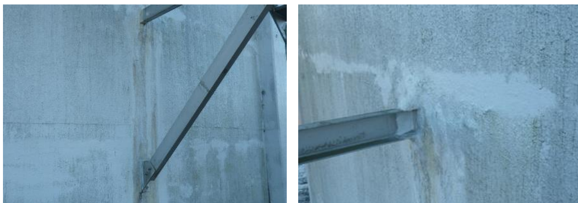
図 3.6 君ヶ岡配水池 No.1 タンク（漏水箇所）
