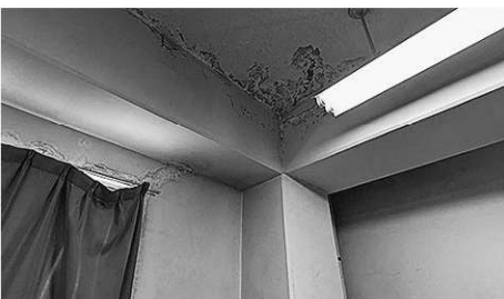
雨漏り被害のある体育館控室
