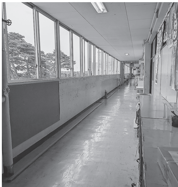
雨漏りが目立つ廊下
