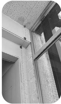
雨漏りといったんだ壁
