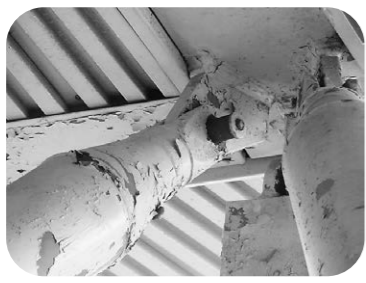
レイキング柱のヒンジナットの緩み部分
