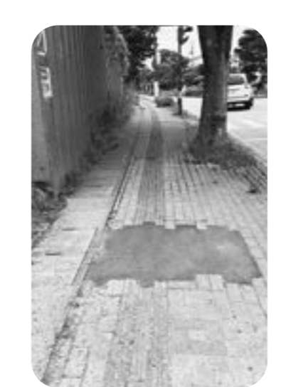
機能していない誘導用ブロック
