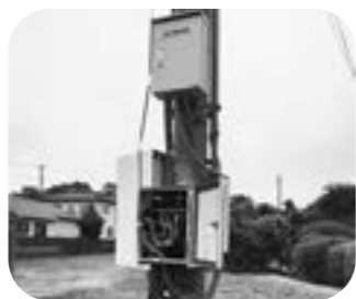
落雷の被害を受けました
