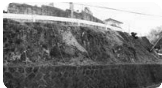
道路脇が崩れている箇所もあり危険な状態
