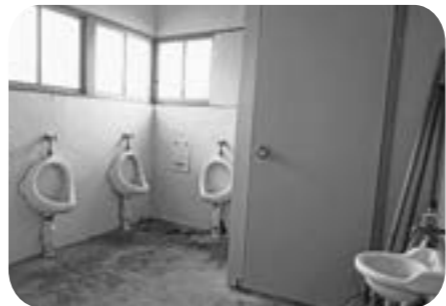
壊れて水漏れする男子トイレ
