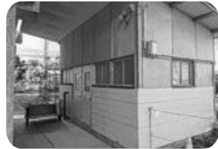
建替えが必要な体育館トイレ
