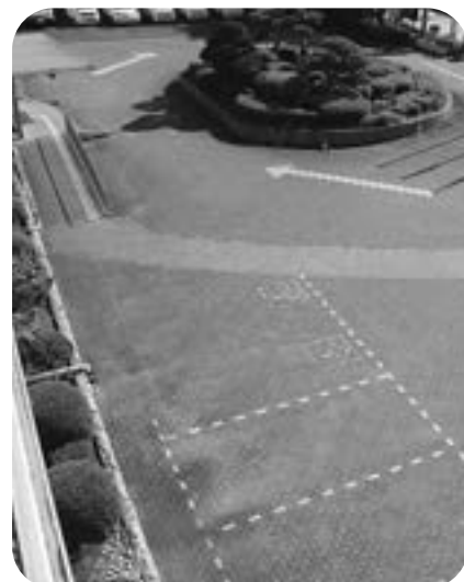
消えかかった白線 (施工前)
