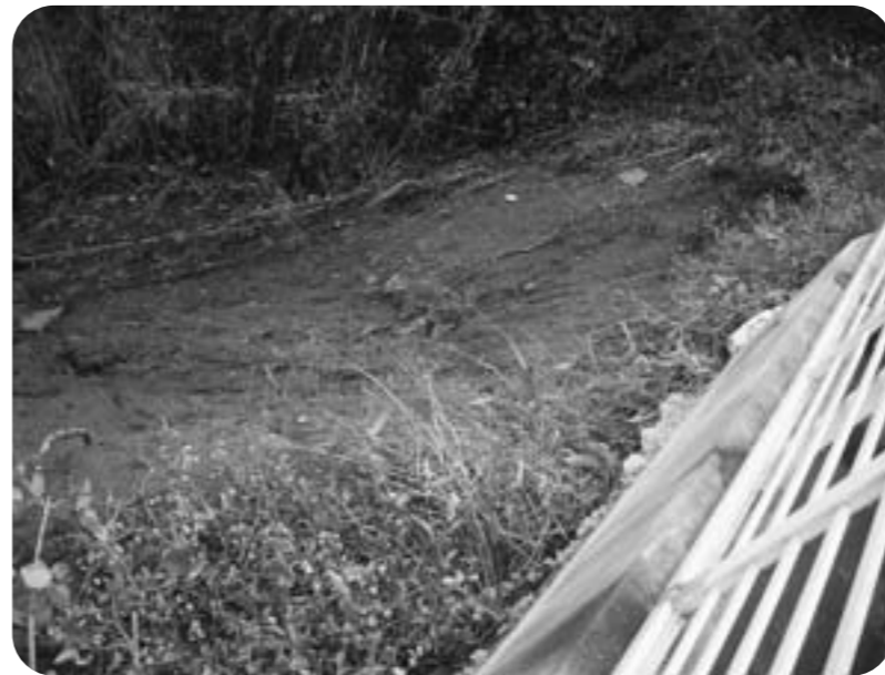
要害地区の土砂崩落現場
