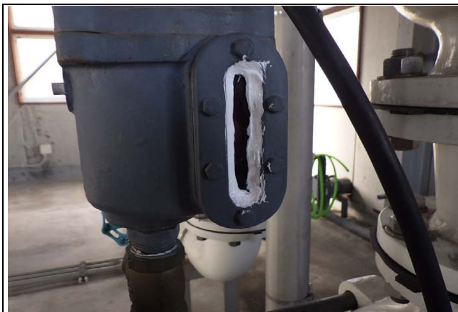
遠山ポンプ場 送水ポンプNo.1 満水検知器
