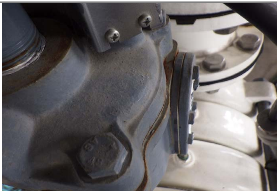
遠山ポンプ場 送水ポンプNo.1 満水検知器
