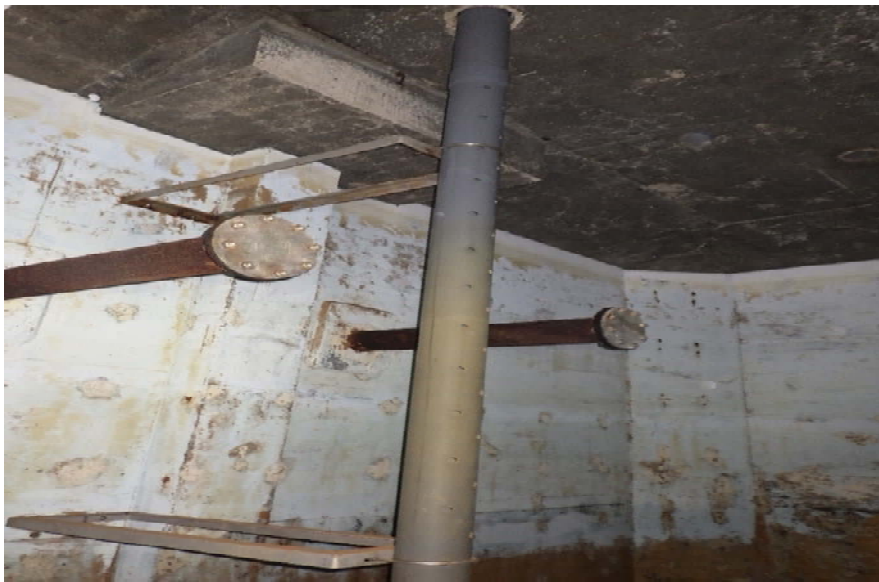
遠山ポンプ場 受水槽水位計交換 受水槽内部 防波管内 水位計 上部
